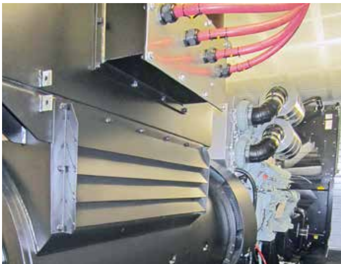
2,000 kVA / 11 kV应急发电机组
